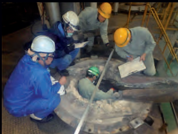
技術指導: 耐火ライニングの解体調査 (耐火ライニングのトラブルの確認)
