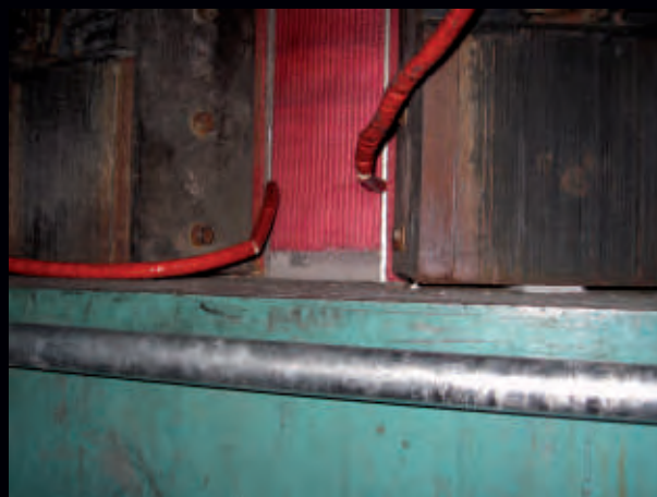
10 t 炉における SAVESEARCH ® 電極接続の様子
