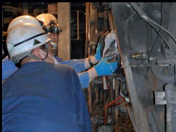
解体調査 システムの表示残厚の検証 (溝型炉)
